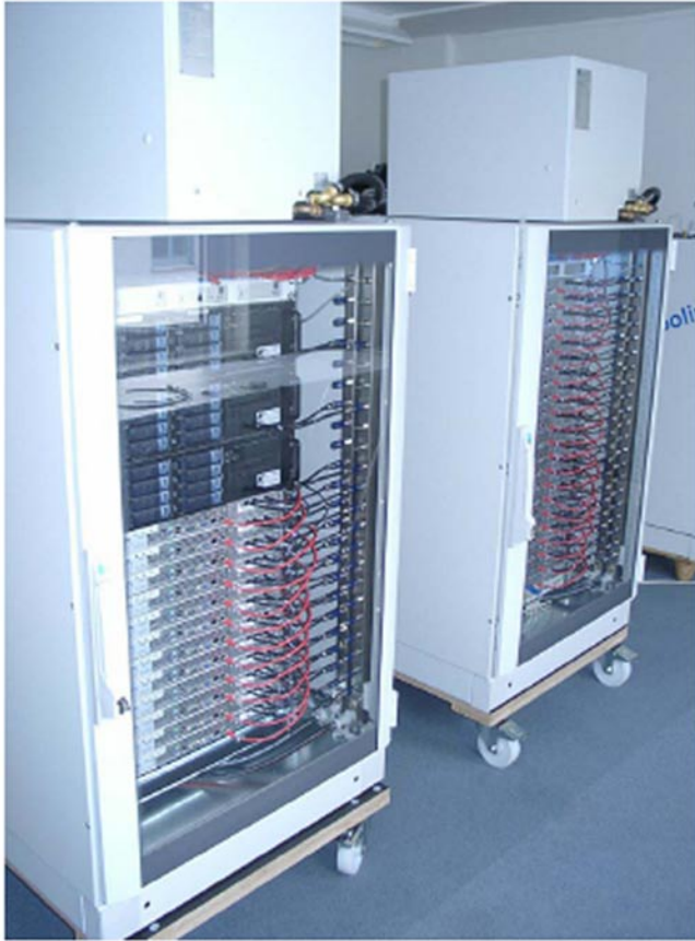
FIGURA 5.- "CLUSTER" QUE PROCESA Y GUARDA LAS FOTOS DEL DOT. EN LA FOTO SE ADPECIAN LOS CABLES NEGROS QUE SON LOS TUBOS DE ENFRÍAMIENTO POR AGUA)
